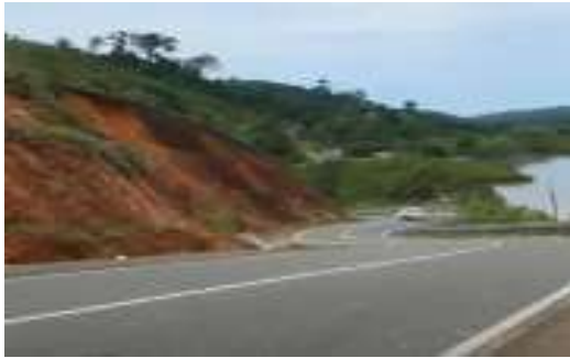
Gambar 5. Kondisi Jalan Raya ke Mandeh
